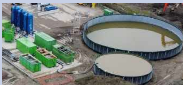
Ecoterres, lavage de sols pollués par des PFAS + traitement des eaux de lavage.
